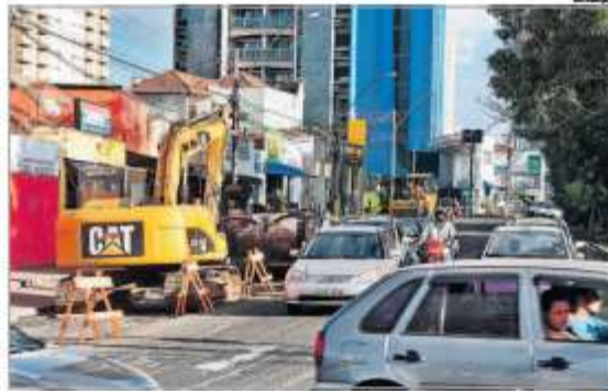
Obras na avenida Afonso de Saldes Oliveira: o drama da mobilidade urbana e os congestionamentos
