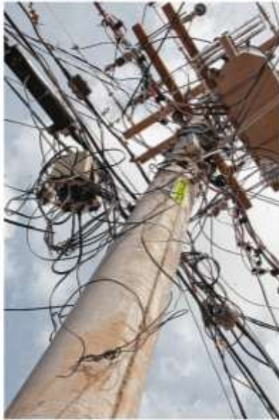
Apesar de a resolução limitar o número máximo de pontos de instalação para cabos em postes, amarranhados são comuns
